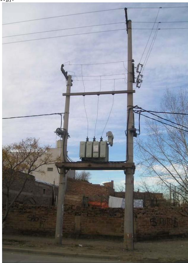
Fig. 1. Subestación 13.2/0.4 kV con dos puestas a tierra
